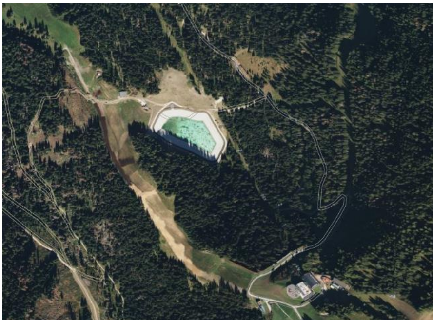
Figura 20: Nuovo bacino per innevamento della capacità massima di circa 50.000 m 3 , collocato in località Frataces sulla p.c. 908/1 alla quota di 1.755 m s.l.m.
